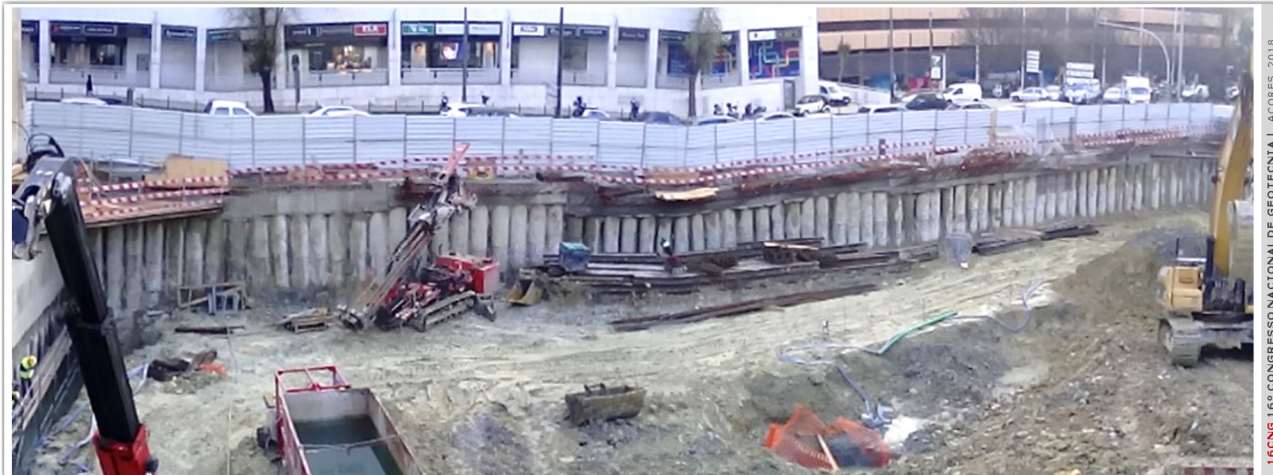
Figura 6 – Vista da escavação em janeiro de 2016, com os trabalhos interrompidos no alçado AB, que confronta para Av. Fontes Pereira de Melo
